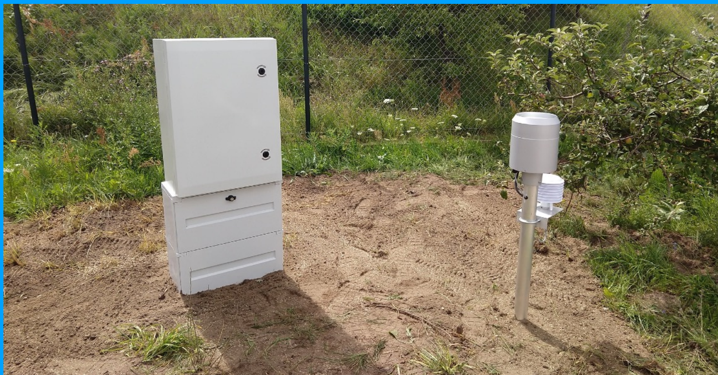
Zdjęcie 1. Przykład deszczomierza korytkowego. W tym wypadku instalacja została dodatkowo wyposażona w czujnik temperatury i wilgotności powietrza. Został on umieszczony w specjalnej osłonie radiacyjnej minimalizującej wpływ słońca.
